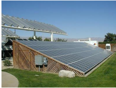
Gambar 1. Pembangkit listrik tenaga surya. (Andrew, Rasional, & Peter, 2015)
