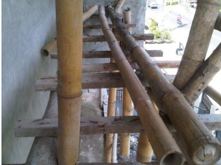
Foto 5.19 Penggunaan perancah bambu yang tidak aman (foto 14)
