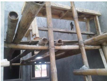
Foto 5.18 Penggunaan perancah bambu yang tidak aman (foto 13)
