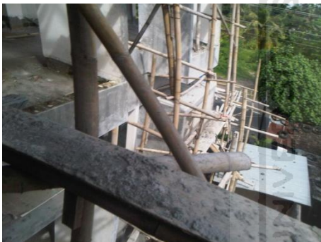
Foto 5.17 Penggunaan perancah bambu yang tidak aman (foto 8)
