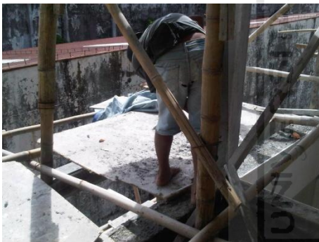
Foto 5.20 Penggunaan perancah bambu yang tidak aman (foto 16)
