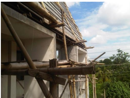
Foto 5.21 Penggunaan perancah bambu yang tidak aman (foto 19)
