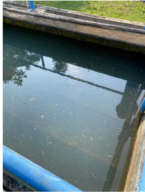
j. Dedaunan pada Bak Filtrasi
