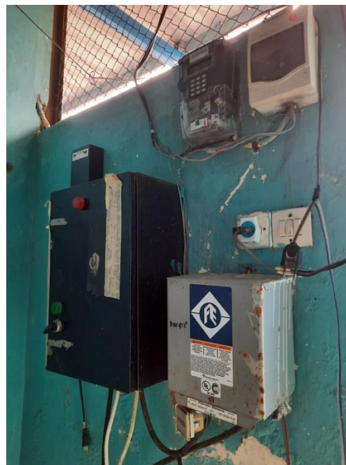
Gambar 4. 12 Panel Listrik dan WLC
