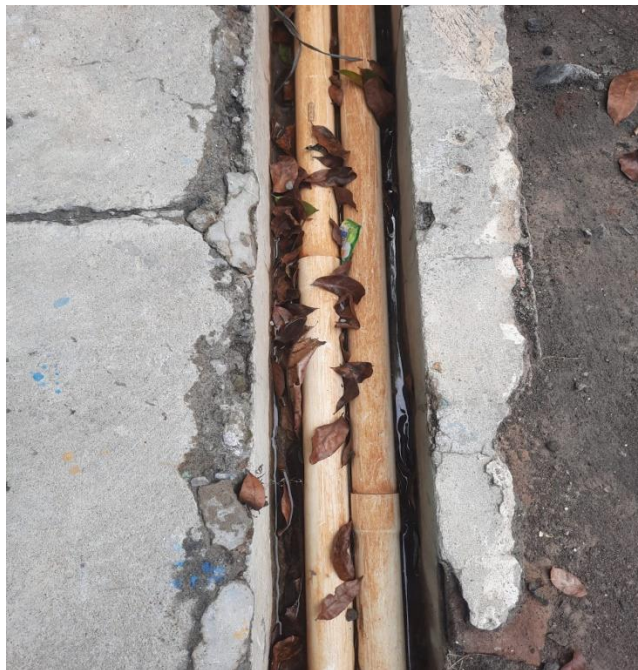
Gambar 4. 8 Pipa Jaringan Distribusi ke IPA
