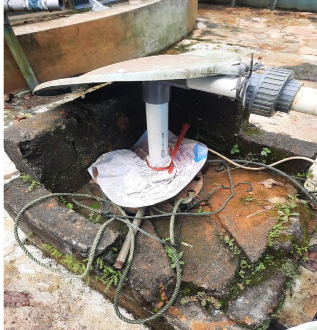
Gambar 4. 6 Sumur Surodadi dan Pompa
