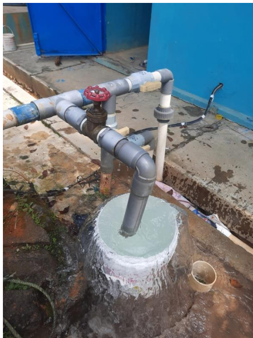
Warna Air dari Sumur Surodadi setelah pompa dibersihkan
