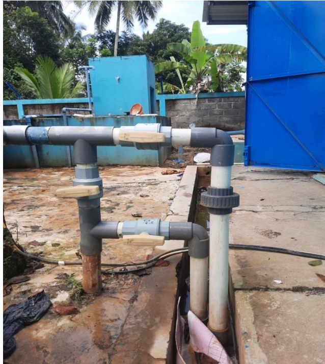
Gambar 4. 7 Pipa Jaringan Utama
