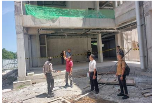
Gambar 1. 1 Pekerja bangunan dari NTT Terjatuh dari Ketinggian
