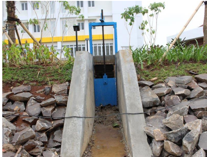
Gambar 3.10 Pintu Air (sumber : BBWS Pemali-Juana)
