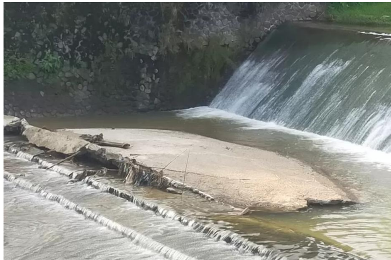
Gambar 1.1 Kerusakan pada Kolam Olak di Bendung Santok, Kota Pariaman
