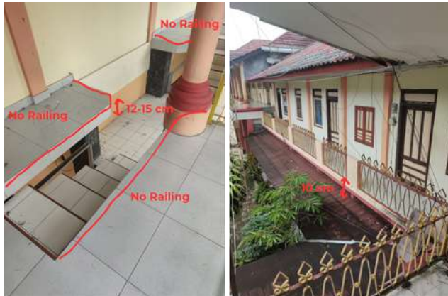
Gambar 1.5 Railing Tangga Barat (Kiri) dan Plat Lantai (Kanan) Sumber: penulis, 2024
