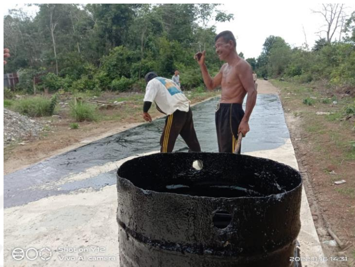
Gambar 1.1 Pekerja Tidak Safety
