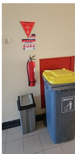
Gambar 4. 11 Hydrant tidak sesuai
