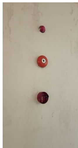
Gambar 4. 15 Kerusakan minor alarm
