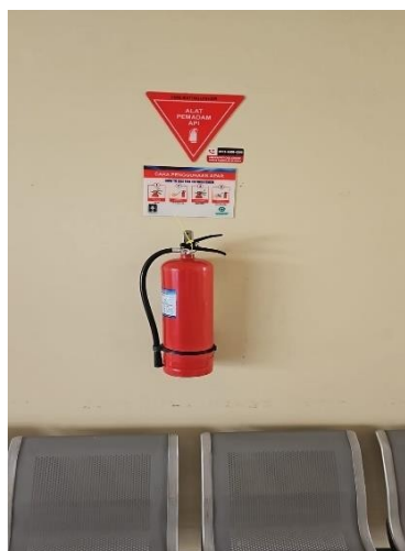
Gambar 4. 9 APAR tidak sesuai
