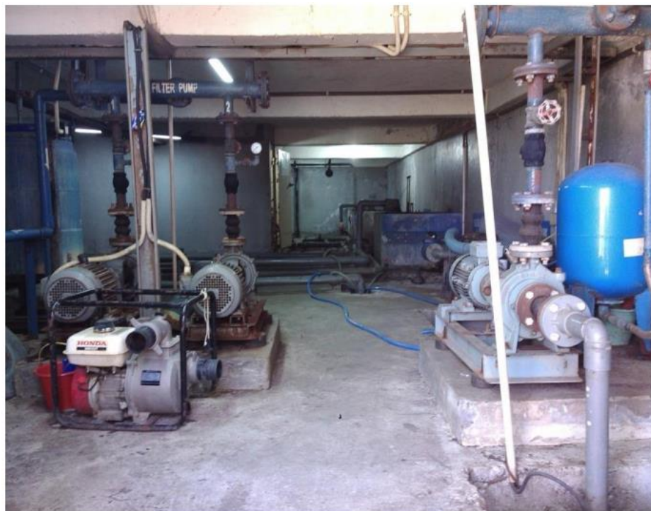
Gambar 4.3 IPAL lama Bandara Adi Soemarmo, Kab. Boyolali, Jawa Tengah
