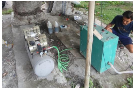
Gambar L 4. 2 Instalasi Compressor Udara Dengan Foam Generator
