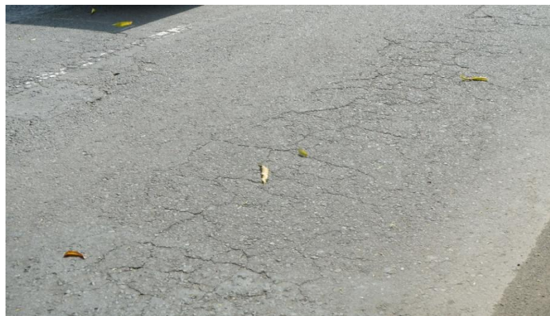
Gambar 1.1 Kondisi Jalan Sultan Agung (Retak Kulit Buaya) Sta. 0+600
