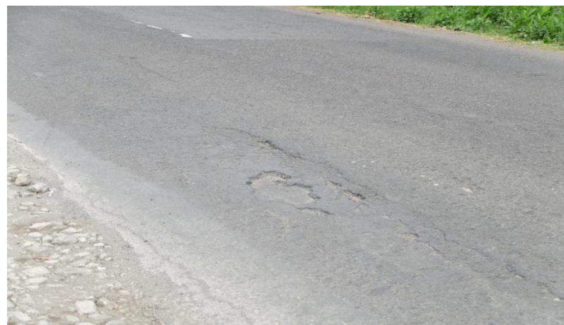
Gambar 1.2 Kondisi Jalan Sultan Agung (Kerusakan Berlubang) Sta. 1+000
