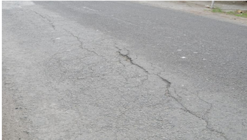
Gambar 1.3 Kondisi Jalan Sultan Agung (Retak Memanjang) Sta. 1+200
