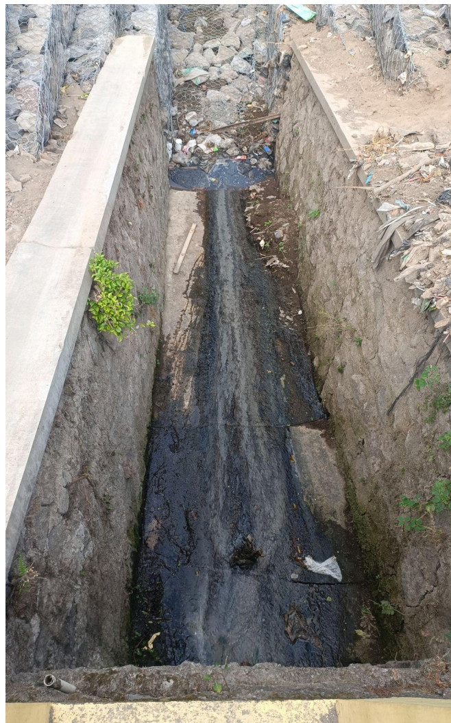
Lampiran 6 Saluran Drainase pada Kecamatan Banjarsari
