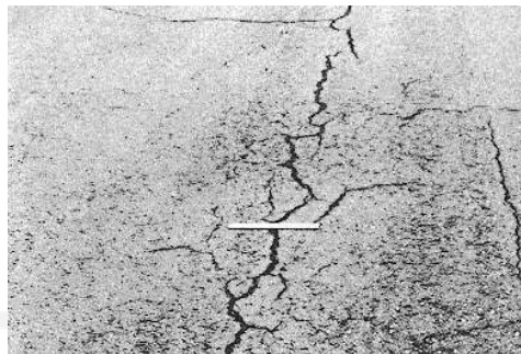
Gambar 3.17 Tingkat Medium Kerusakan Longitudinal and Transverse Cracking
