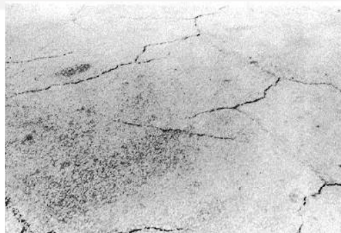
Gambar 3.4 Tingkat Low Kerusakan Block cracking
