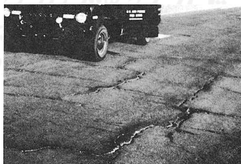
Gambar 3.6 Tingkat High Kerusakan Block cracking
