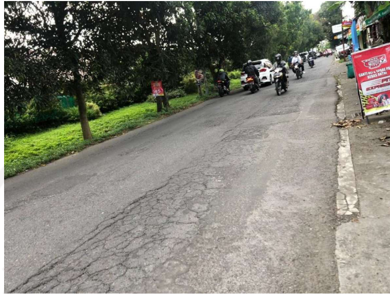
Gambar 1.2 Kerusakan Permukaan Jalan Sta.0+500
