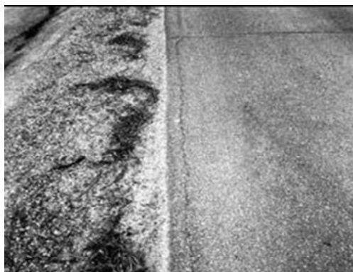
Gambar 3.10 Tingkat Low Kerusakan Edge Cracking
