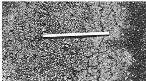
Gambar 3.29 Tingkat Low Kerusakan Weathering and Raveling
