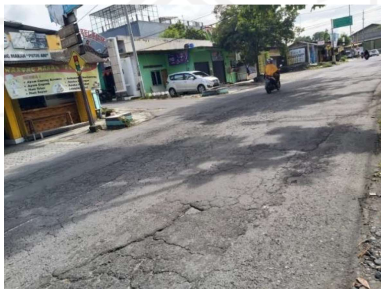
Gambar 1.1 Kerusakan Permukaan Jalan Sta.00+000
