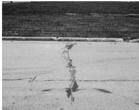
Gambar 3.18 Tingkat High Kerusakan Longitudinal and Transverse Cracking
