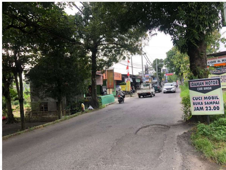
Gambar 1.3 Kerusakan Permukaan Jalan Sta.01+000
