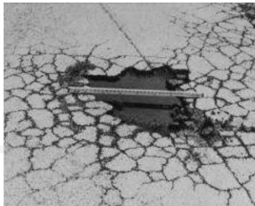
Gambar 3.25 Tingkat High Kerusakan Potholes
