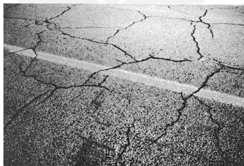
Gambar 3.5 Tingkat Medium Kerusakan Block cracking
