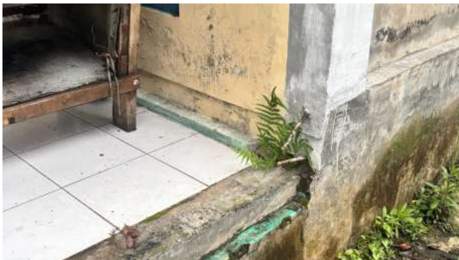
Gambar 5. 9 Besi Tulangan Terlihat
