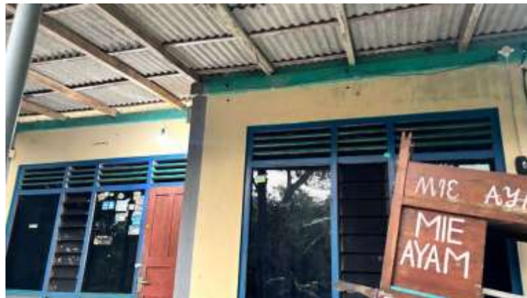
Gambar 5. 6 Kondisi Elektrikal Bangunan yang Kurang Memadai
