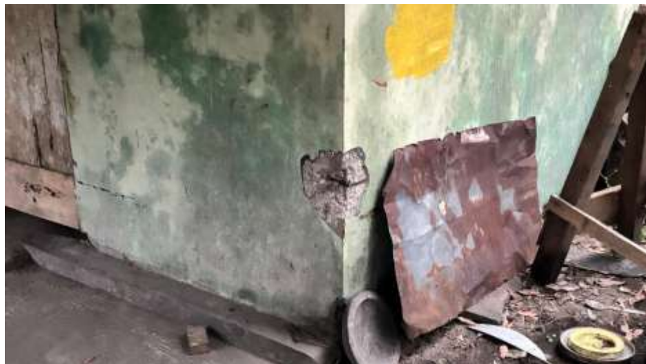
Gambar 5. 10 Kondisi Dinding Bangunan
