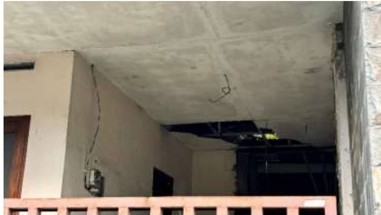
Gambar 5. 8 Kondisi Mekanikal Bangunan yang Kurang Memadai
