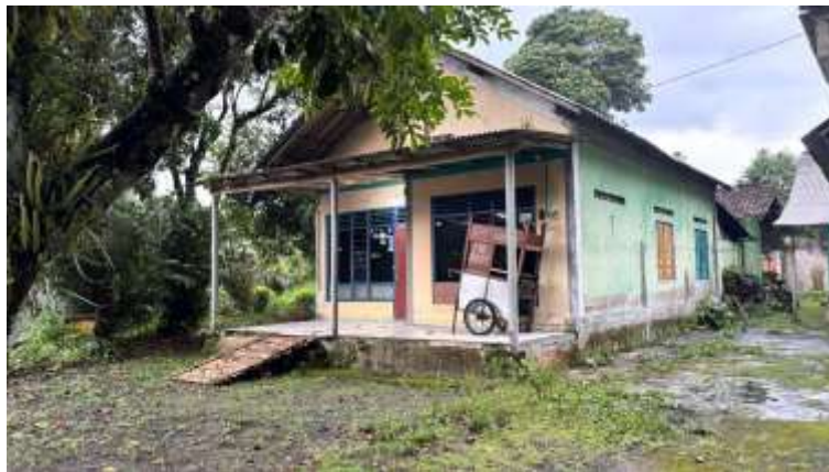
Gambar 5. 4 Kondisi Tata Lingkungan Rumah Tinggal yang Kurang Baik
