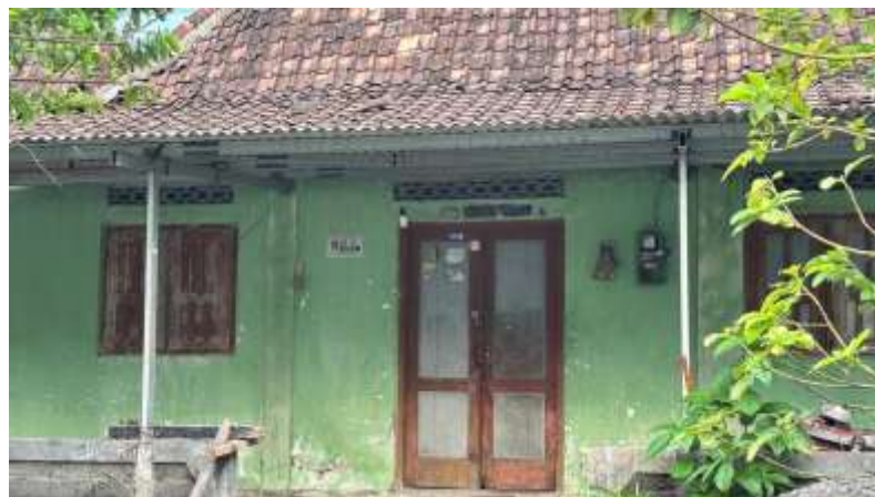
Gambar 5. 7 Kondisi Mekanikal yang Tidak Terawat
