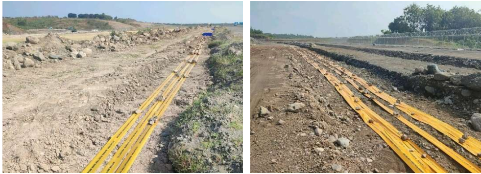
Gambar 3. 4 Aplikasi Warning Tape di Jalur Pemasangan Kabel
