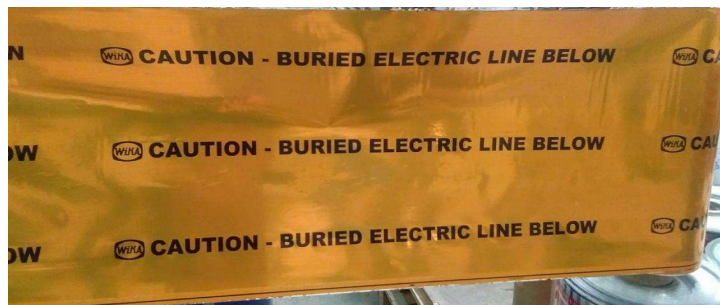
Gambar 3. 5 Warning Tape di Bandara Dhoho Kediri
