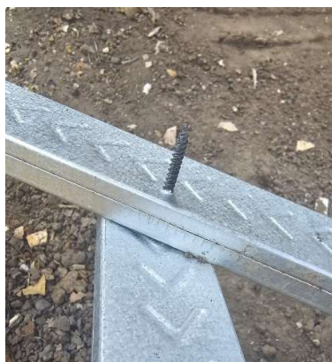
Gambar 5. 2 Baut yang Terekspose Memiliki Risiko Pekerja Tergores
