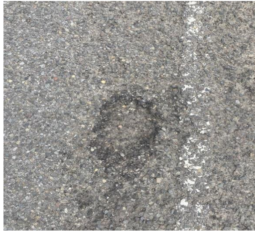
Gambar 1.1 Kerusakan Lubang di Jalan Kaliurang km 17,2
