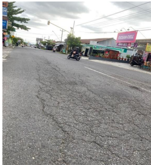
Gambar 1.2 Kerusakan Lubang di Jalan Kaliurang km 17,8
