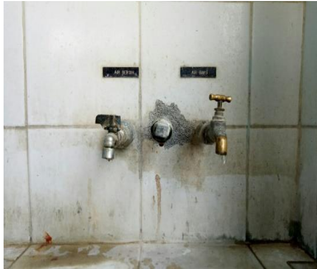
Gambar 4.5 Keran kontrol pada IPA Sermo (Sumber :Dokumentasi, 2018)
