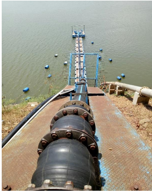
Gambar 4.2 Intake ponton pada IPA Sentolo, unit Kokap (Sumber : Dokumentasi, 2018)
