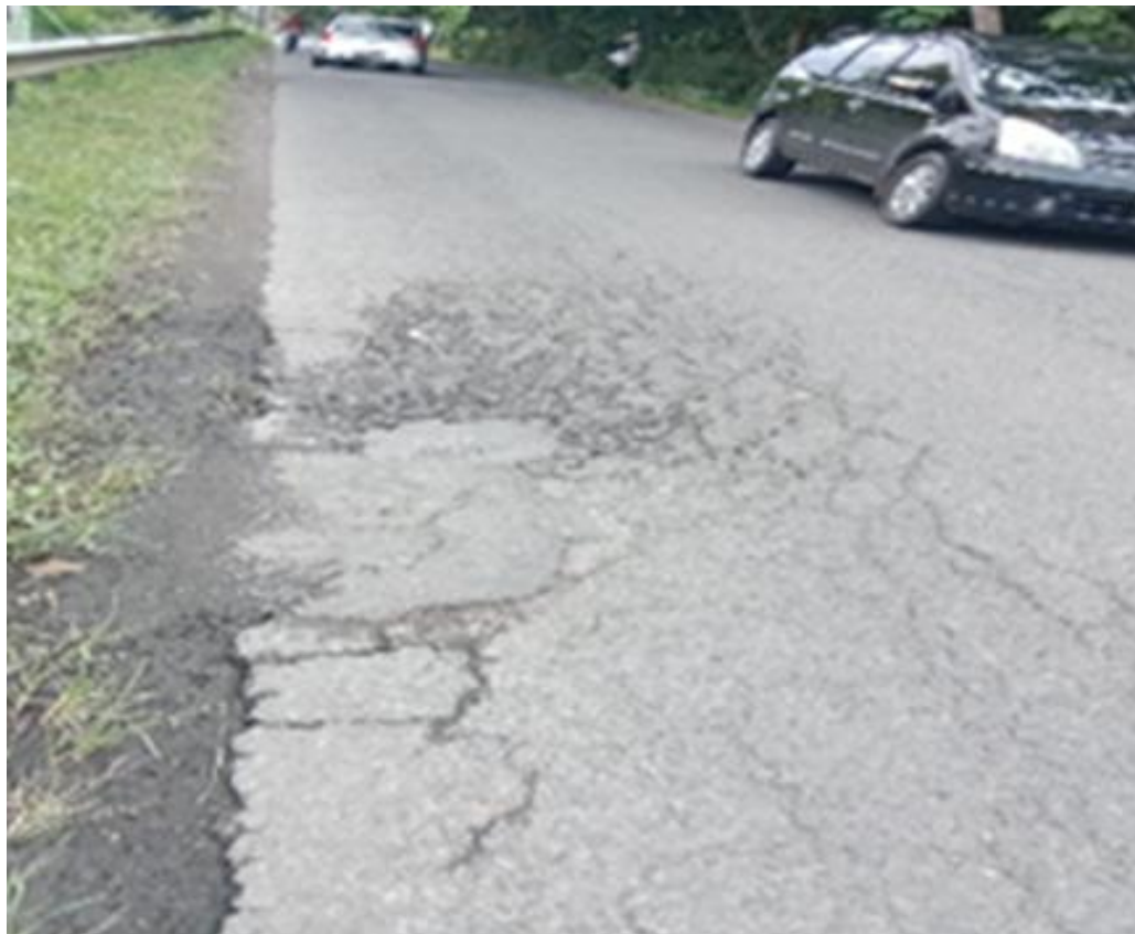
Gambar L-4. 35 Contoh Kerusakan pada Sta 11+900-12+000
