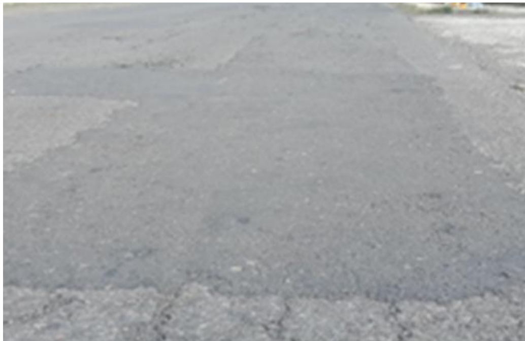
Gambar L-4. 24 Contoh Kerusakan pada Sta 10+800-10+900
