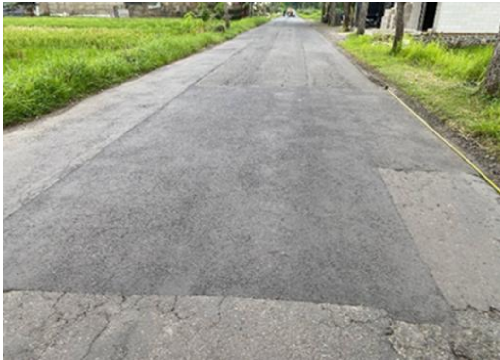
Gambar L-4. 3 Contoh Kerusakan pada Sta 8+700-8+800
