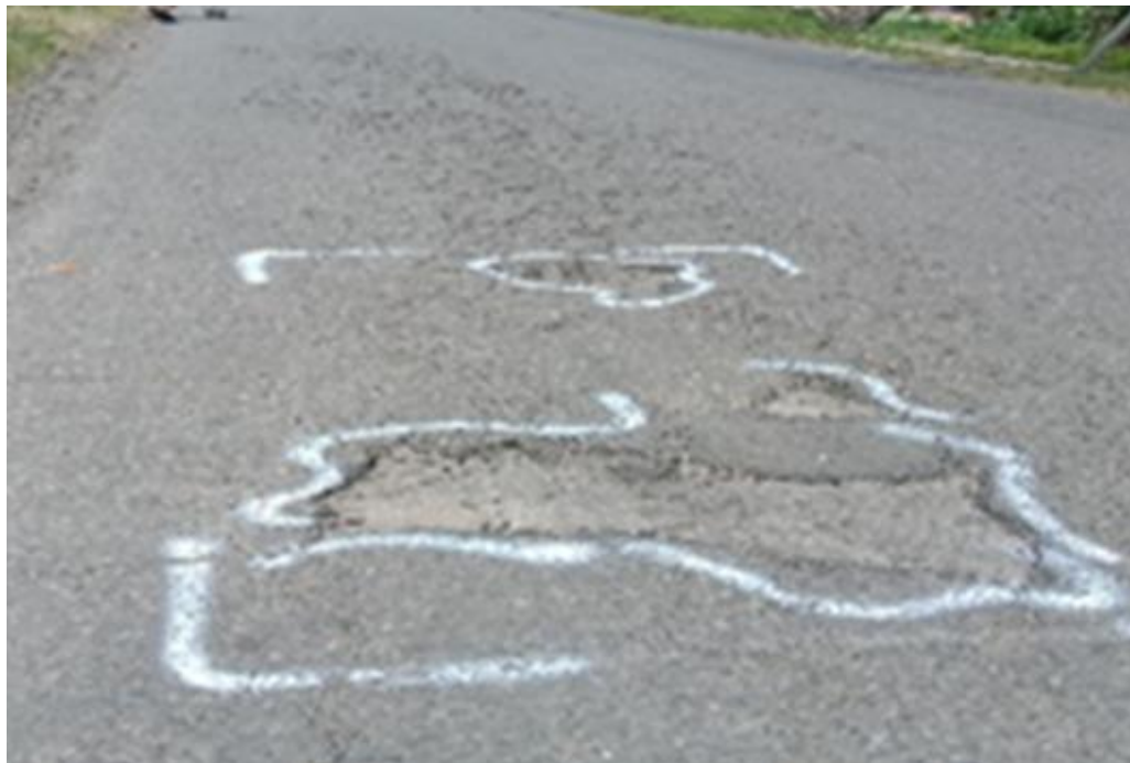
Gambar L-4. 12 Contoh Kerusakan pada Sta 9+600-9+700
