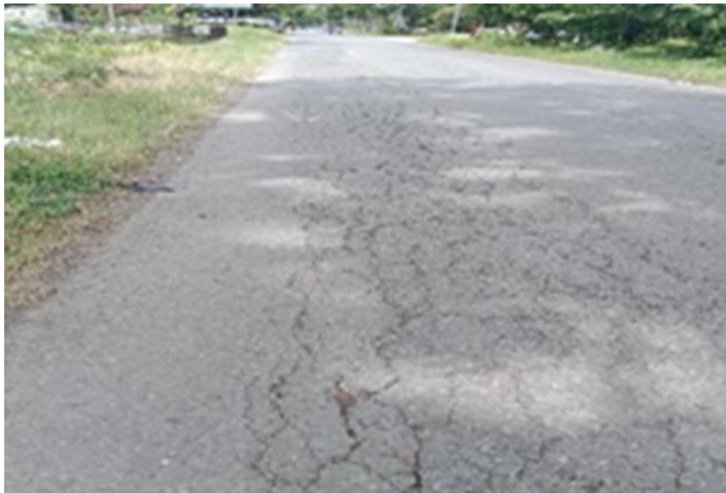
Gambar L-4. 9 Contoh Kerusakan pada Sta 9+300-9+400
