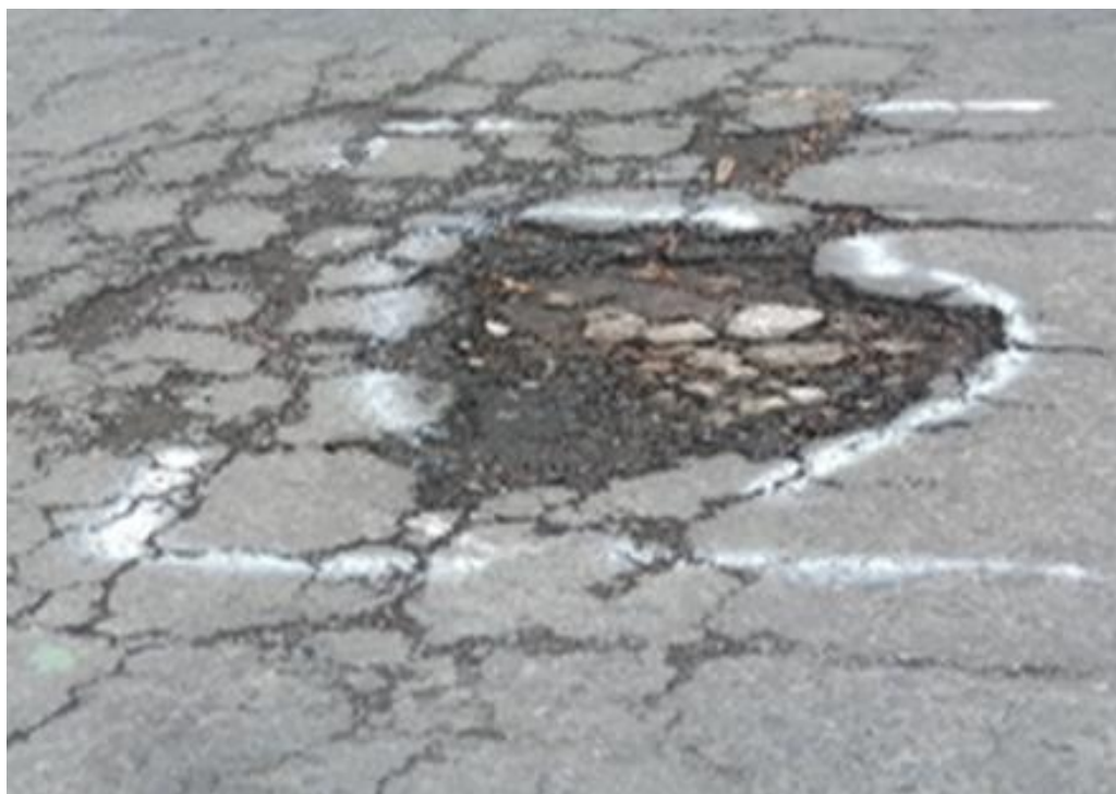
Gambar L-4. 33 Contoh Kerusakan pada Sta 11+700-11+800
