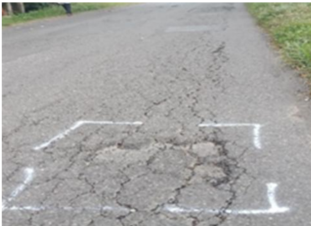
Gambar L-4. 27 Contoh Kerusakan pada Sta 11+100-11+200
