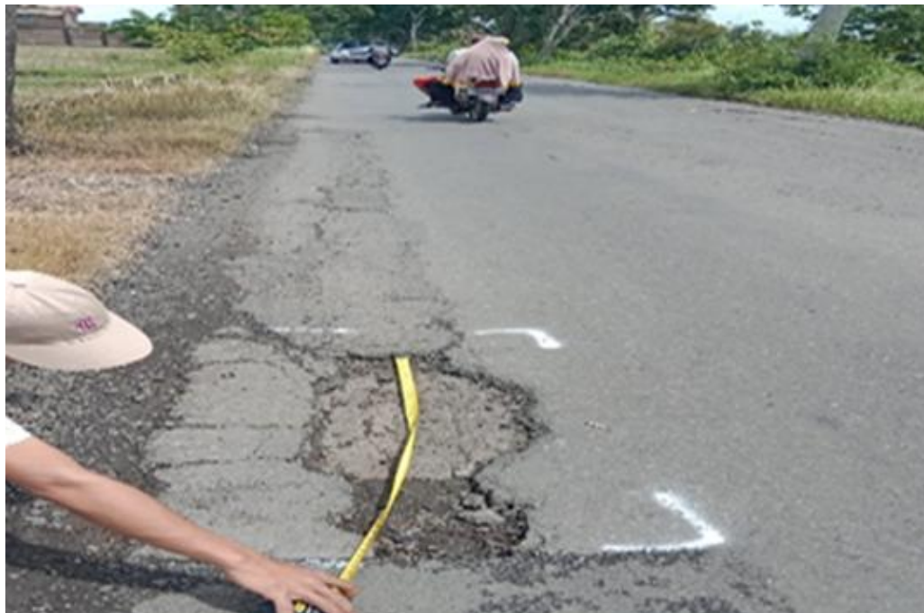
Gambar L-4. 4 Contoh Kerusakan pada Sta 8+800-8+900
