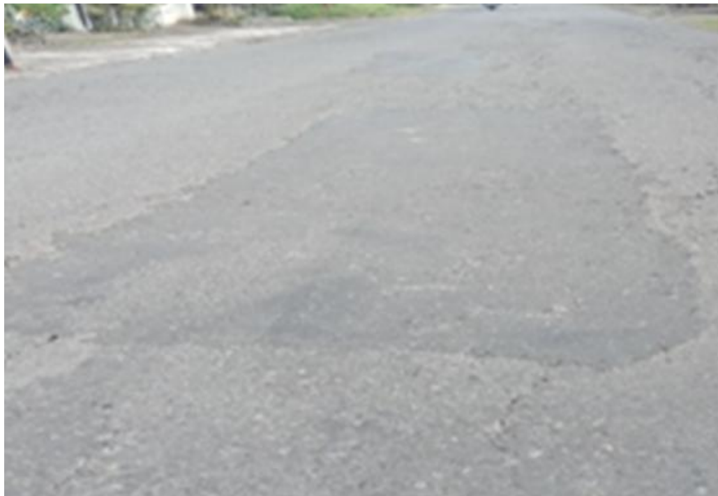
Gambar L-4. 25 Contoh Kerusakan pada Sta 10+900-11+000
