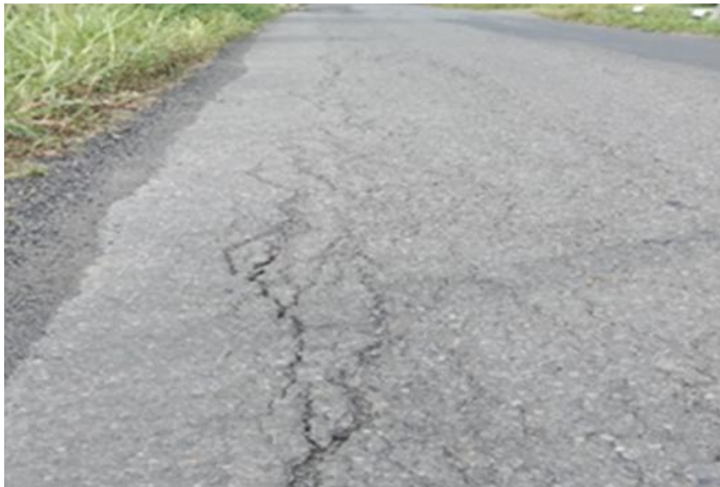
Gambar L-4. 19 Contoh Kerusakan pada Sta 10+300-10+400
