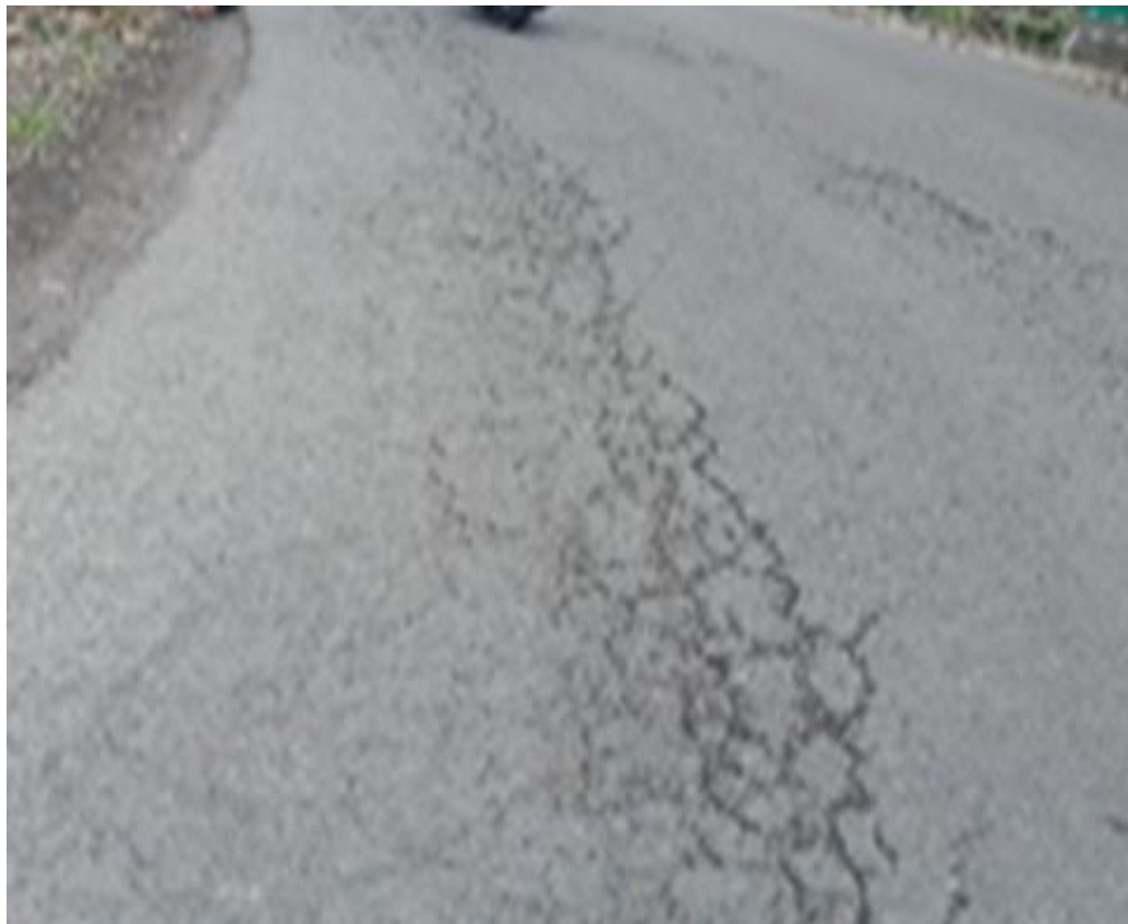
Gambar L-4. 32 Contoh Kerusakan pada Sta 11+600-11+700
