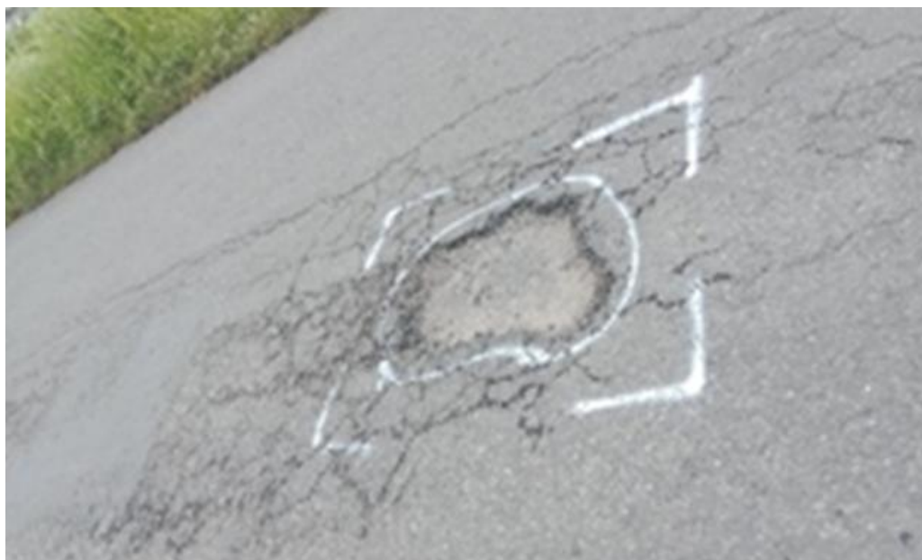
Gambar L-4. 31 Contoh Kerusakan pada Sta 11+500-11+600
