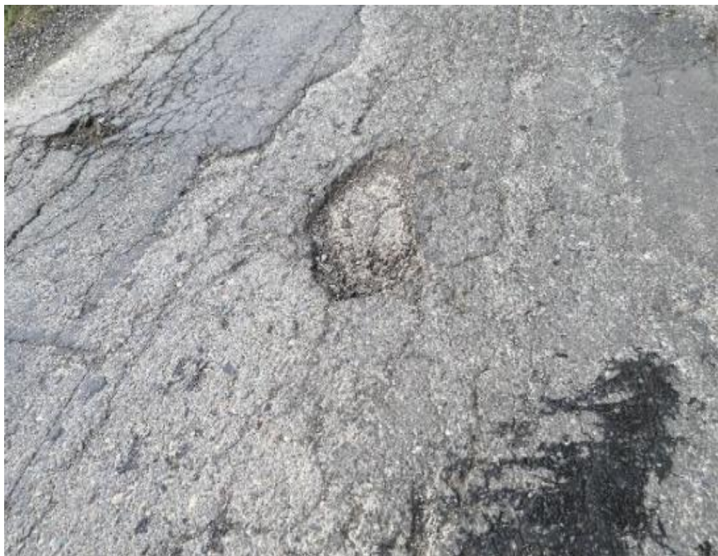
Gambar L-4. 1 Contoh Kerusakan pada Sta 8+500-8+600
