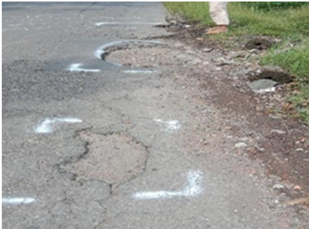
Gambar L-4. 14 Contoh Kerusakan pada Sta 9+800-9+900
