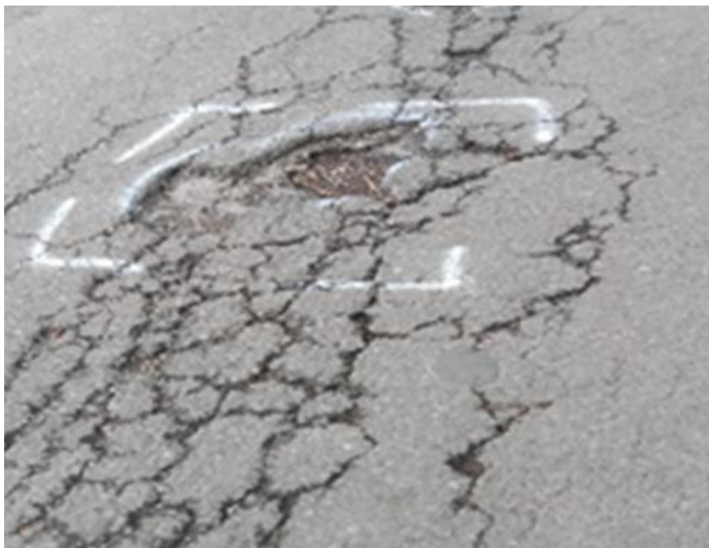
Gambar L-4. 28 Contoh Kerusakan pada Sta 11+200-11+300
