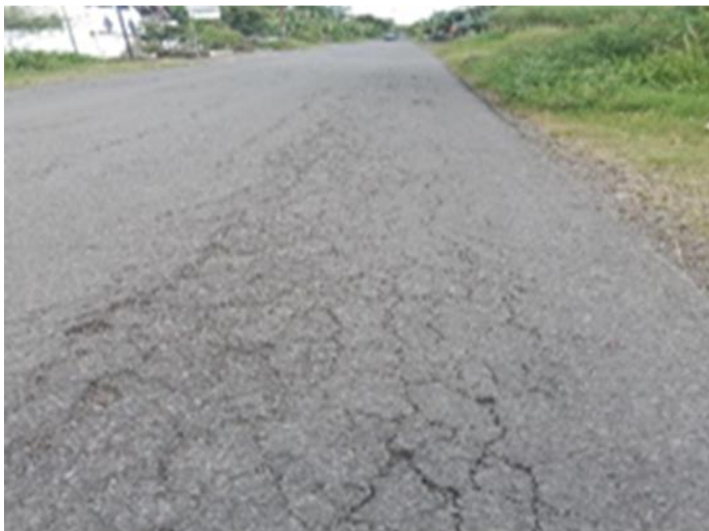
Gambar L-4. 26 Contoh Kerusakan pada Sta 11+000-11+100
