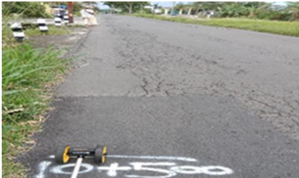
Gambar L-4. 21 Contoh Kerusakan pada Sta 10+500-10+600
