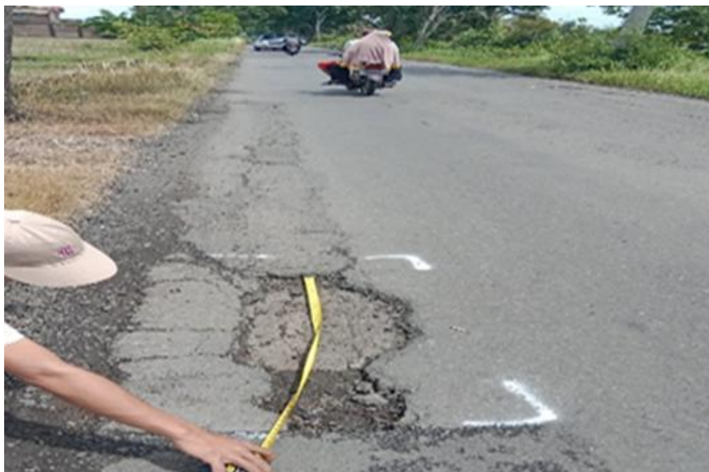
Gambar L-4. 5 Contoh Kerusakan pada Sta 8+900-9+000
