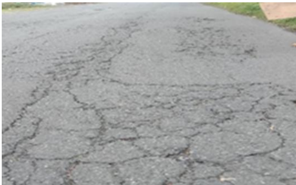
Gambar L-4. 29 Contoh Kerusakan pada Sta 11+300-11+400
