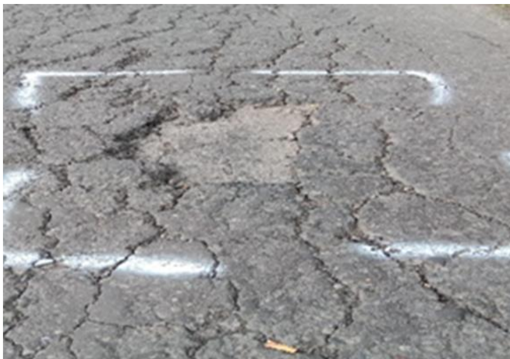
Gambar L-4. 17 Contoh Kerusakan pada Sta 10+100-10+200
