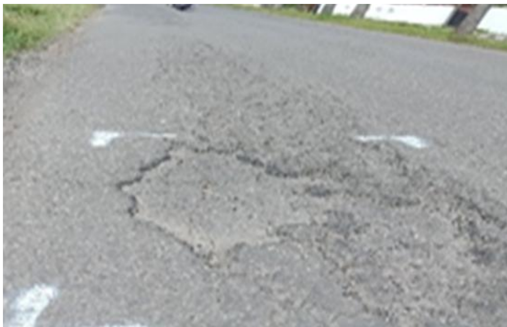
Gambar L-4. 11 Contoh Kerusakan pada Sta 9+500-9+600
