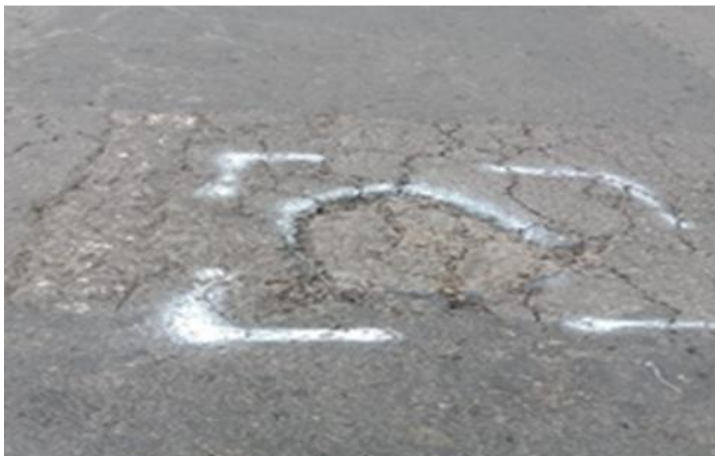
Gambar L-4. 15 Contoh Kerusakan pada Sta 9+900-10+000
