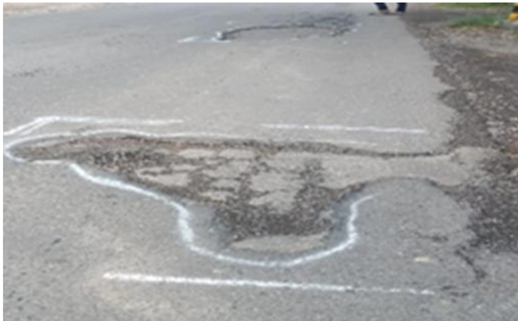
Gambar L-4. 23 Contoh Kerusakan pada Sta 10+700-10+800
