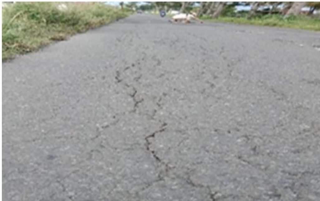
Gambar L-4. 16 Contoh Kerusakan pada Sta 10+000-10+100
