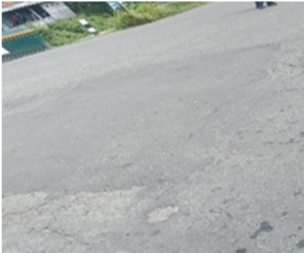
Gambar L-4. 34 Contoh Kerusakan pada Sta 11+800-11+900
