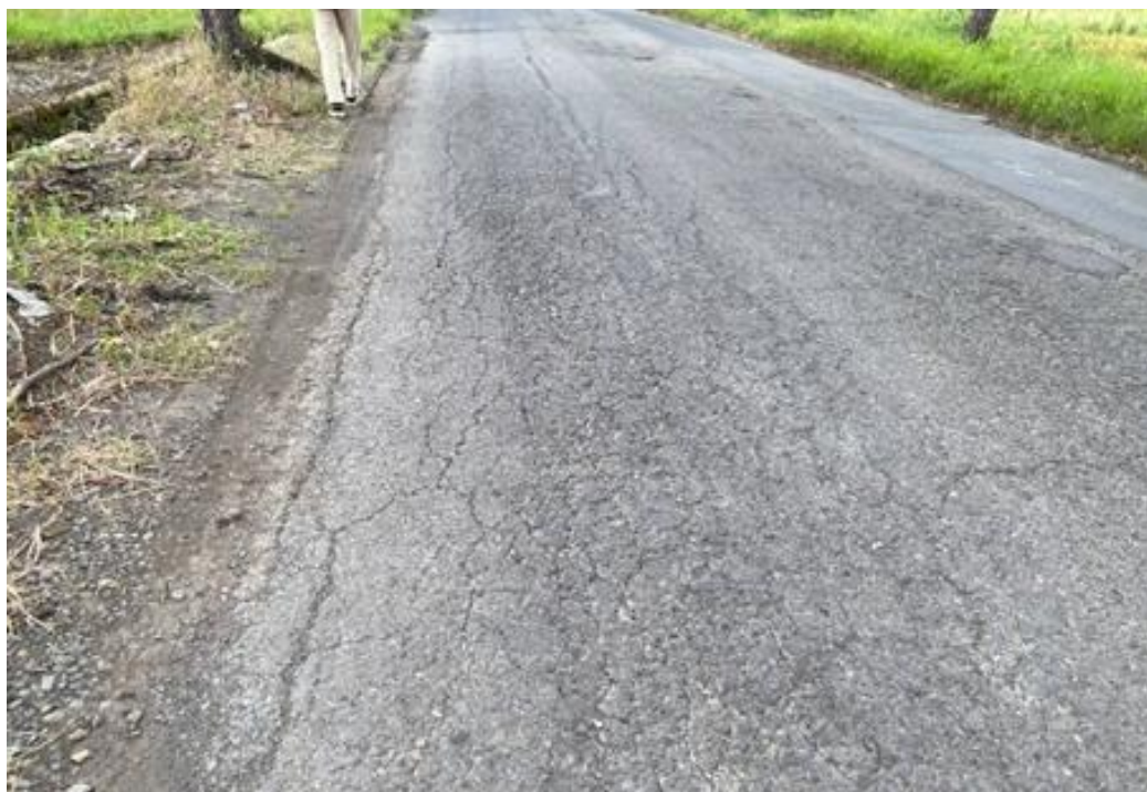
Gambar L-4. 2 Contoh Kerusakan pada Sta 8+600-8+700
