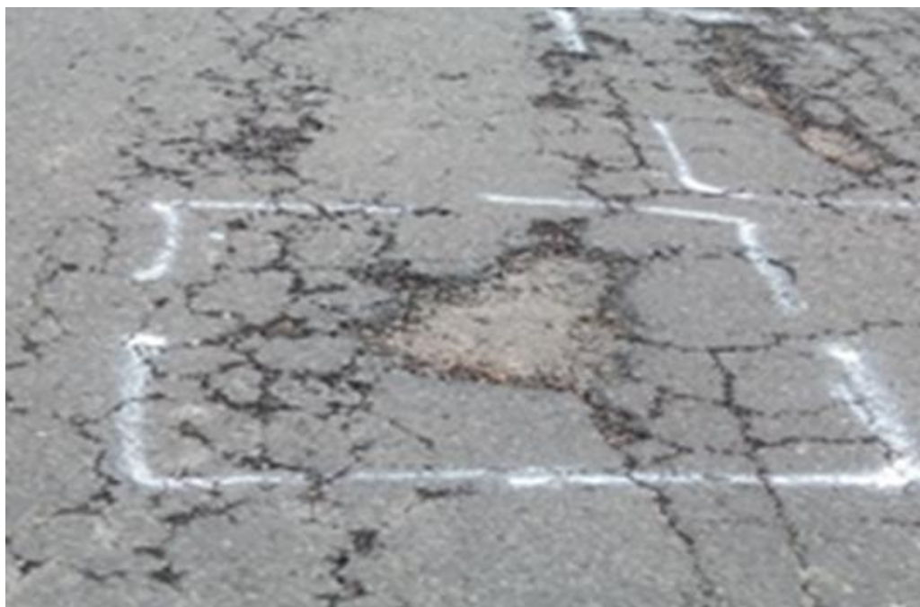
Gambar L-4. 30 Contoh Kerusakan pada Sta 11+400-11+500
