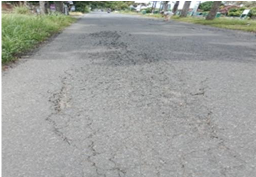
Gambar L-4. 13 Contoh Kerusakan pada Sta 9+700-9+800
