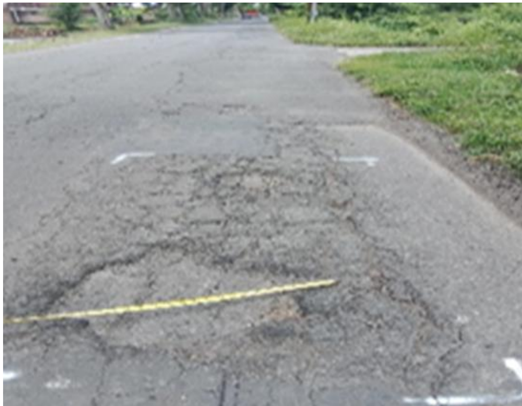
Gambar L-4. 7 Contoh Kerusakan pada Sta 9+100-9+200
