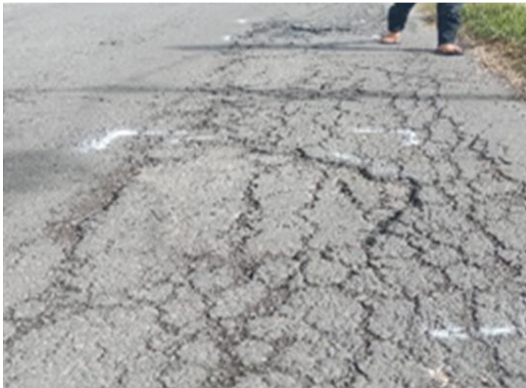
Gambar L-4. 22 Contoh Kerusakan pada Sta 10+600-10+700
