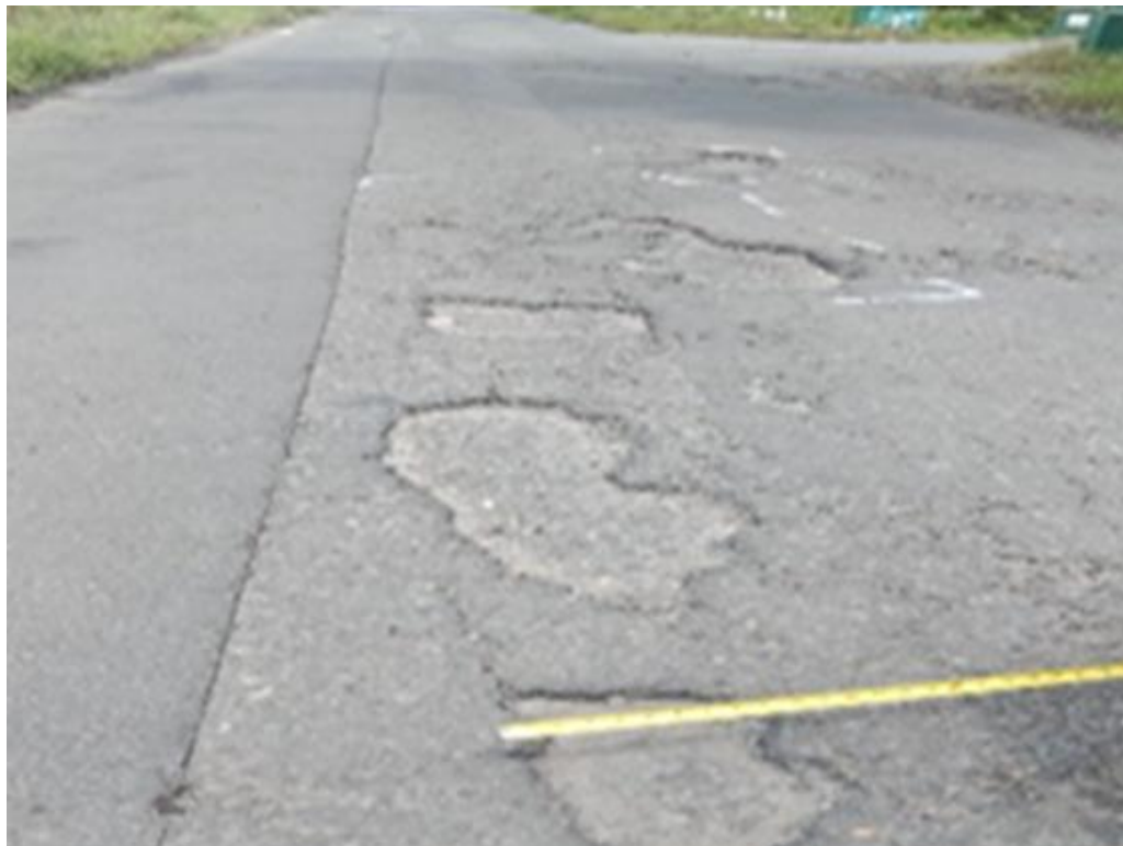
Gambar L-4. 6 Contoh Kerusakan pada Sta 9+000-9+100
