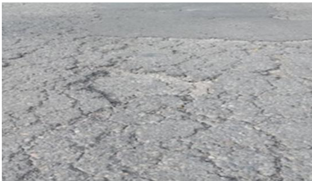
Gambar L-4. 18 Contoh Kerusakan pada Sta 10+200-10+300
