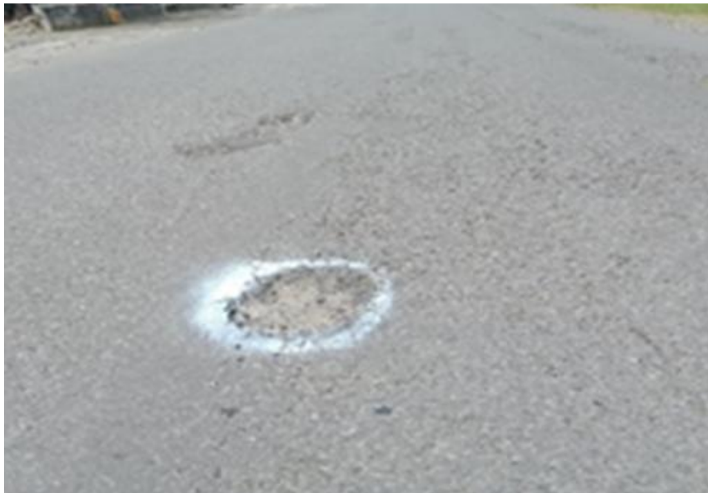
Gambar L-4. 10 Contoh Kerusakan pada Sta 9+400-9+500
