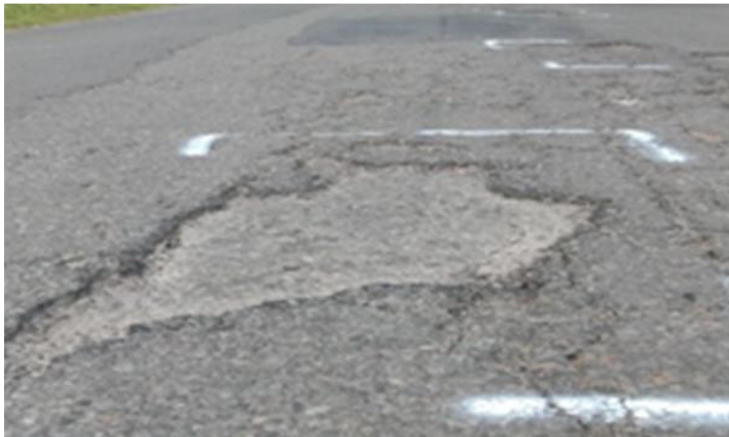
Gambar L-4. 20 Contoh Kerusakan pada Sta 10+400-10+500
