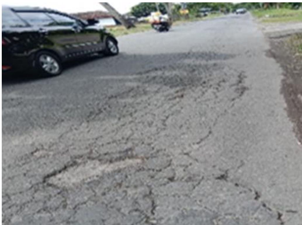
Gambar L-4. 8 Contoh Kerusakan pada Sta 9+200-9+300
