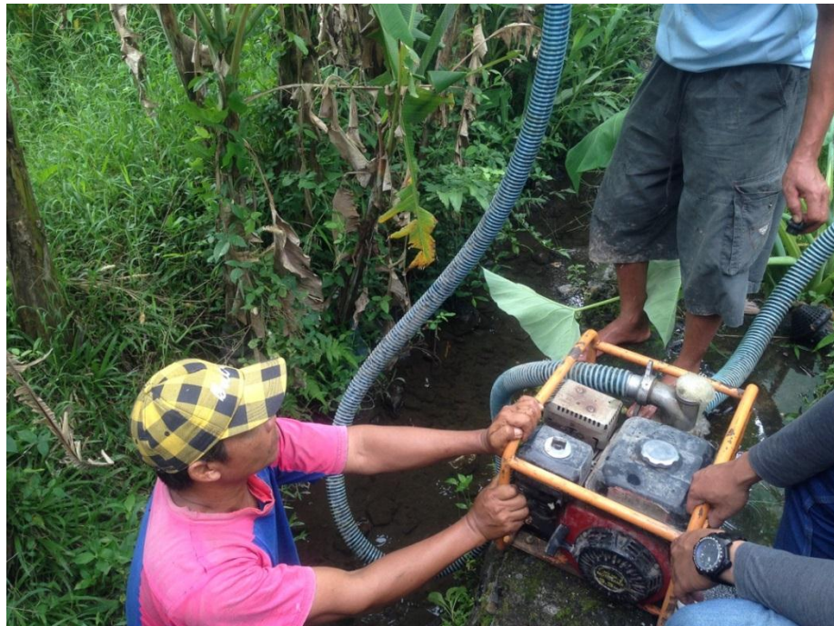
Gambar 4. 3 Pengukuran Debit Menggunakan Pompa
