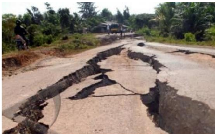
Gambar 3.2 Kerusakan jalan di Provinsi Bengkulu (BAPPENAS, 2007)
