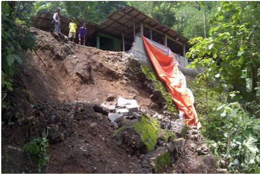
Gambar 1.1 Salah Satu Titik Longsor yang Terjadi di Kabupaten Bantul
