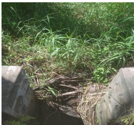
Gambar 6.1 Kondisi Saluran sekunder Mopait
