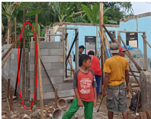
Gambar 5. Penggunaan tulangan yang tidak standart pada proses renovasi rumah
