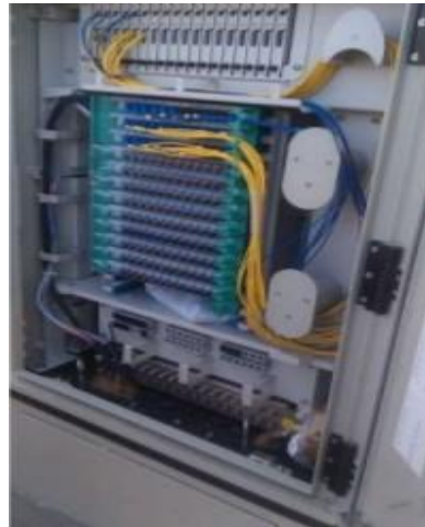
Gambar 3.6. Optical Distribution Cabinet (ODC) [15]
