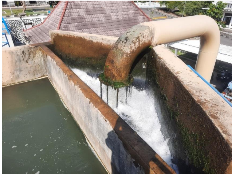
Gambar 4. 10 Inlet Unit Koagulasi
