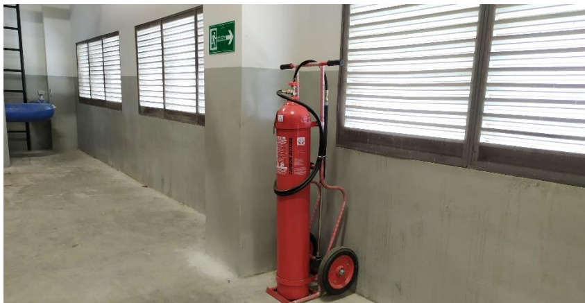
Gambar 4.16 Fasilitas Darurat APAR di STP
