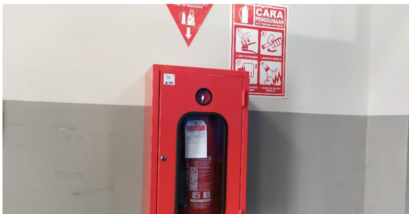
Gambar 4.17 Fasilitas Darurat APAR di STP
