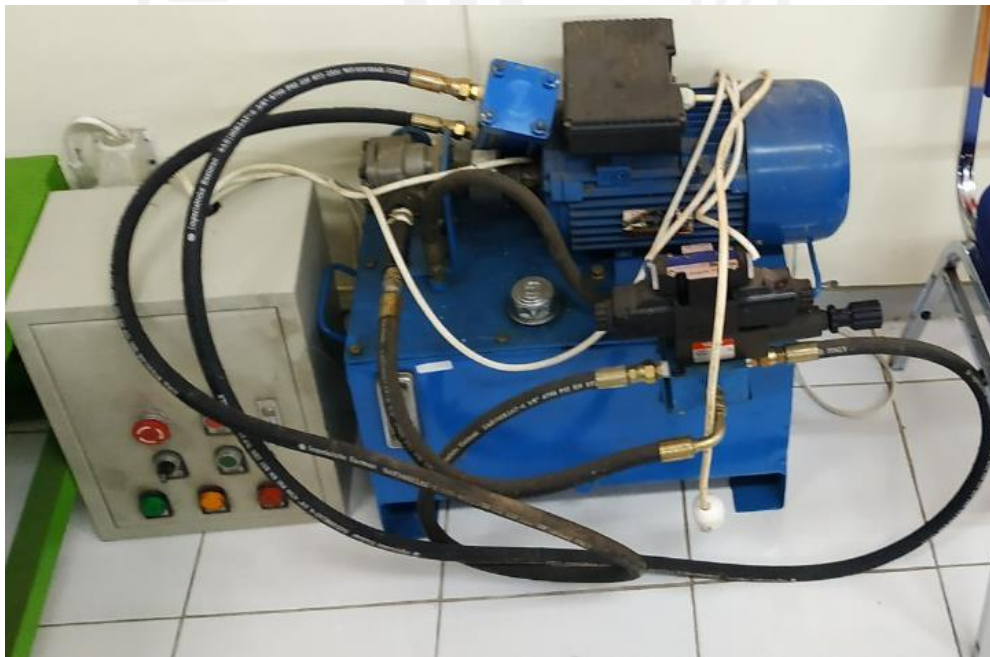
Gambar 4- 9 Controll box dan pompa oli.
