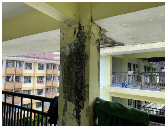
Gambar 5. 3 Kolom Rembes dan berlumut (Sumber: Dokumentasi Pribadi)
