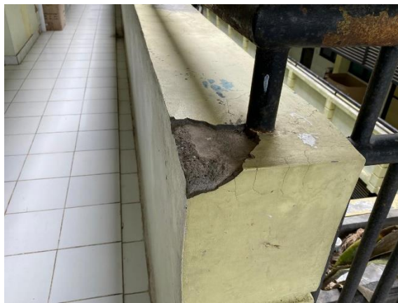
Gambar 5. 1 Retak pada dinding pembatas (Sumber: Dokumentasi Pribadi)
