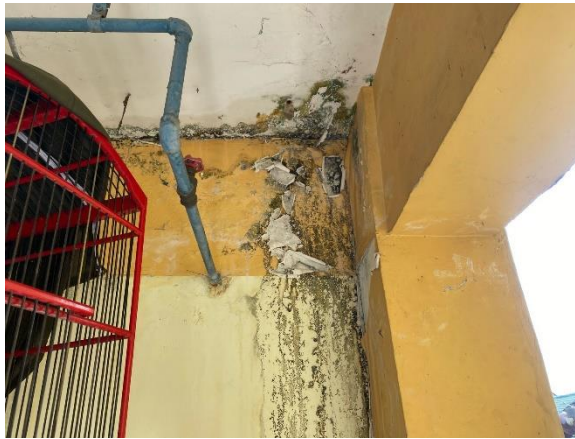
Gambar 5. 2 Rembes pada dinding (Sumber: Dokumentasi Pribadi)
