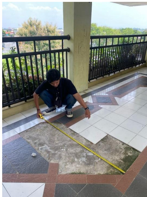
Gambar 5. 6 Lantai keramik yang pecah (Sumber: Dokumentasi Pribadi)
