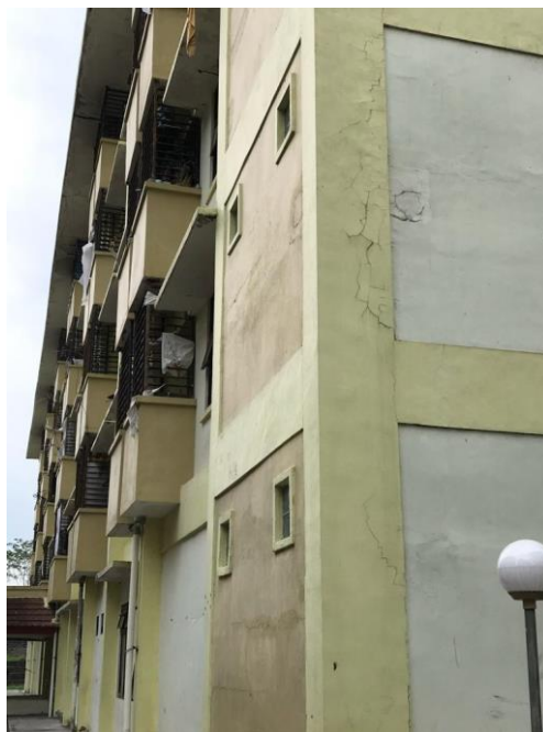
Gambar 5. 4 Retak pada permukaan Kolom (Sumber: Dokumentasi Pribadi)
