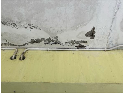
Gambar 5. 5 Pelat lantai mengelupas (Sumber: Dokumentasi Pribadi)
