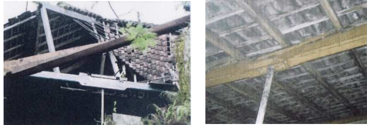
(Kerusakan Pada Bagian Atap)
