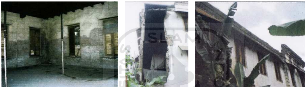
(Situasi dan Kondisi struktur dinding hingga dibagian dinding bagian atap)
